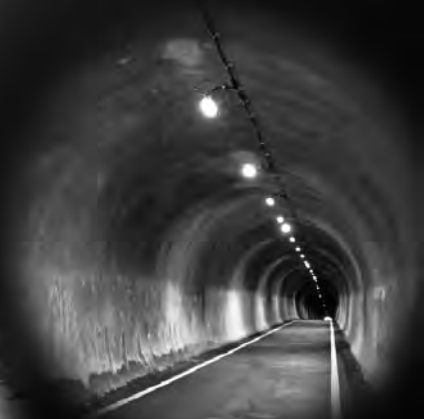
トンネル照明
