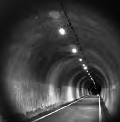
トンネル照明
